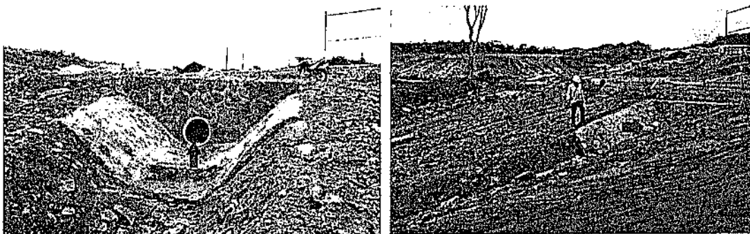
Foto N° 3 – N°4. Fecha: 15 de Noviembre de 2017. Ubicación: Municipio de Tubará/Atlántico, Complejo Campestre Jwaeirruku. Observaciones: Descole de infraestructura.
